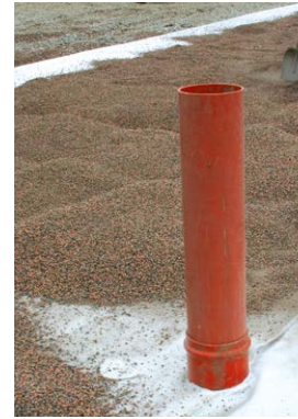
Herausragendes Inspektionsrohr DN 200
